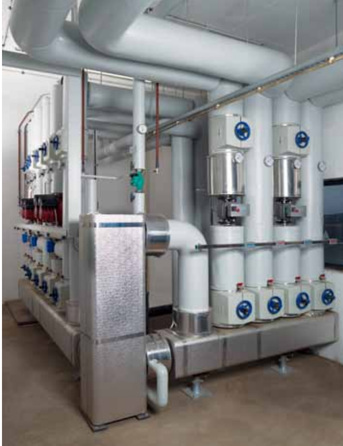
Sinus Mehrtemperaturzonen-Weiche: 600 KW Zweikesselanlage, kombiniert sekundärseitig mit 4 Heizkreisen
